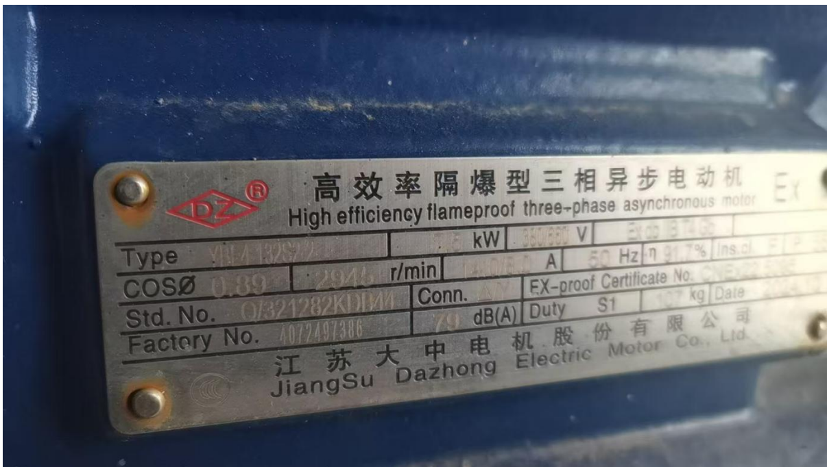
碱洗循环泵电机
