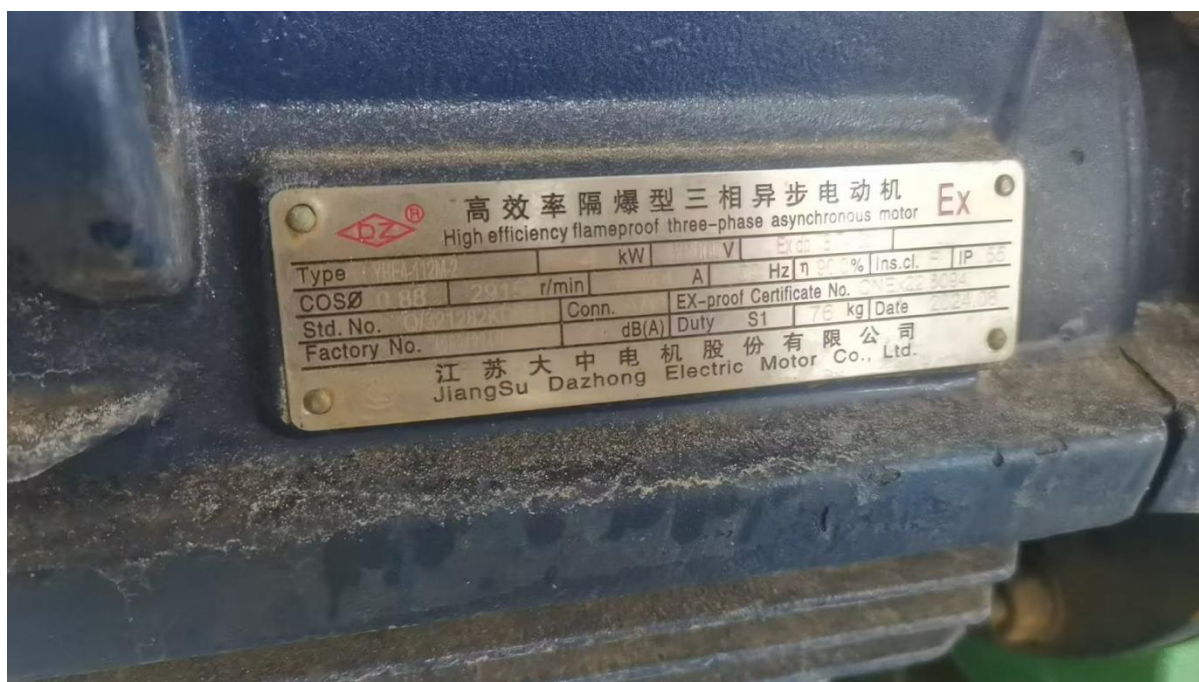
原料溶剂打料泵电机
