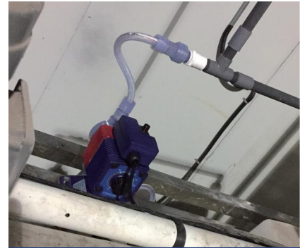
污水处理 Sewage Treatment
