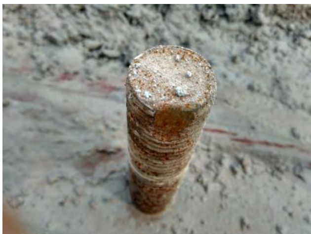
螺栓丝扣损坏
