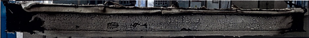
图片 2 耐火试验结束时构件情况
