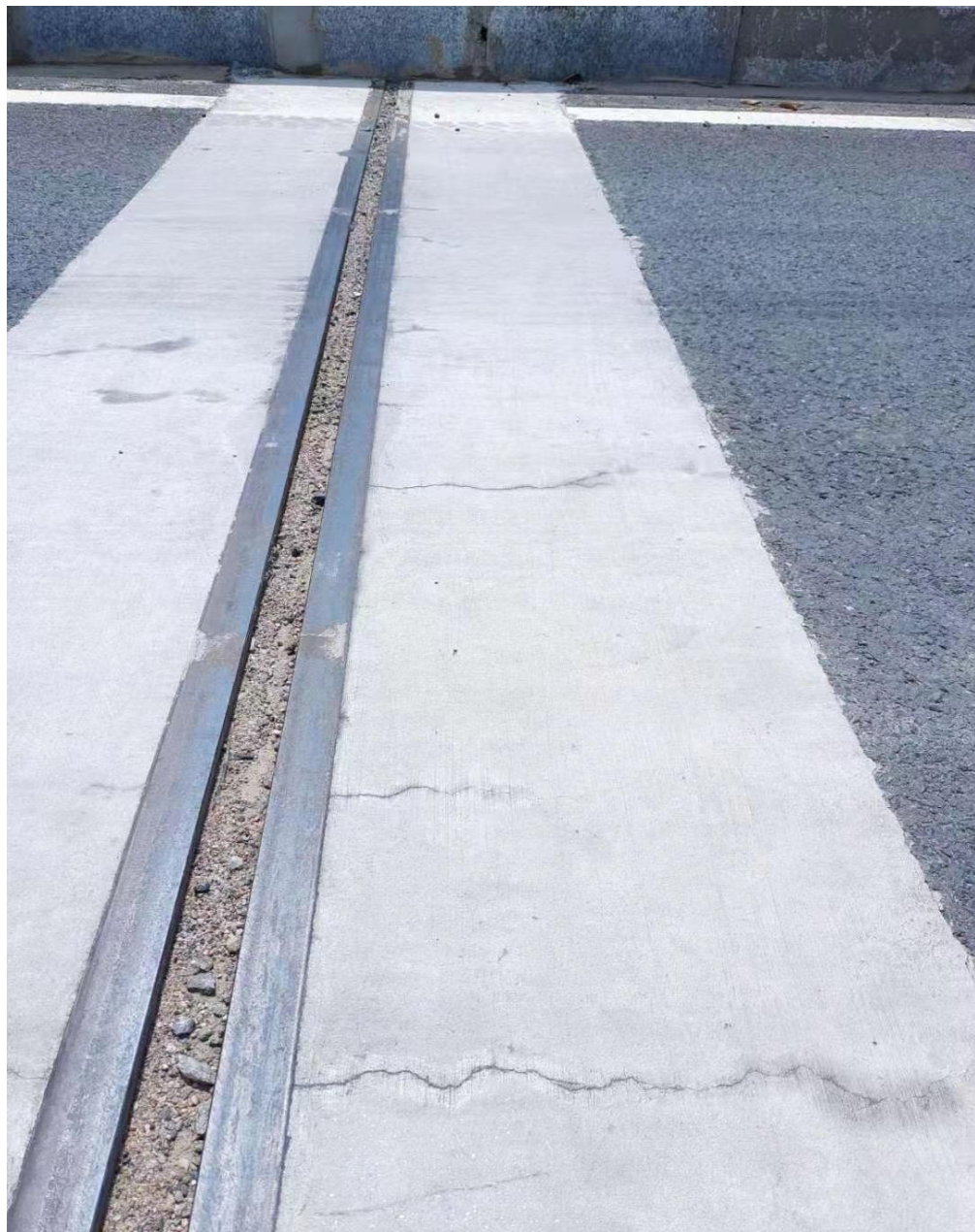
S108同期同段GQF-Z80毛勒式伸缩缝 三个月实拍，可以发现在型钢两侧水泥层已经 出现开裂现象
