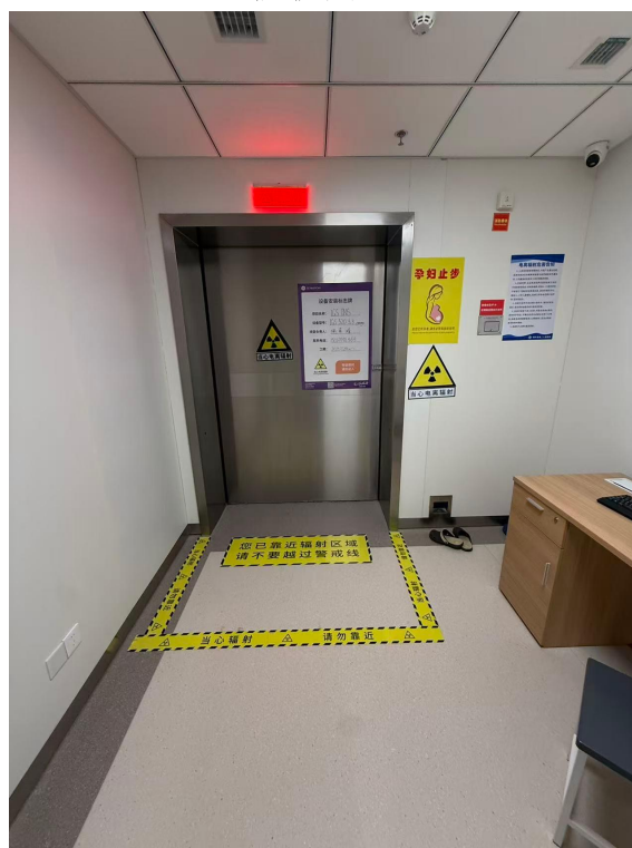
警示标志、危害告知、地面警戒线
