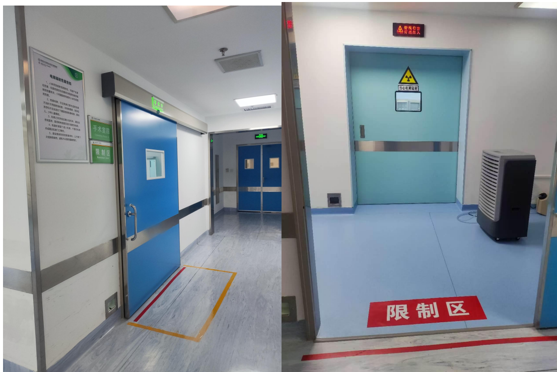
缓冲区外门（危害告知、地面警戒线）
